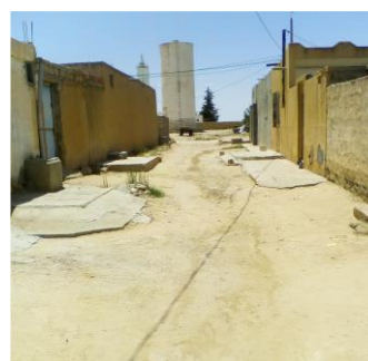
Des puits perdus installés dans la rue à la zone An-Nwayel
